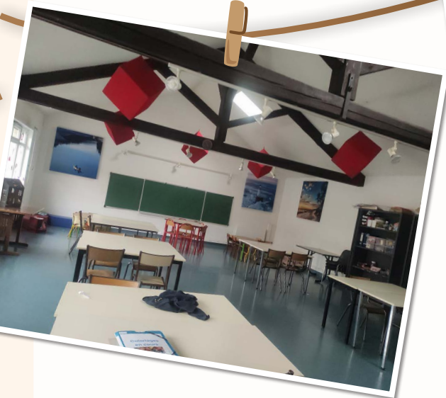
Absorbeurs acoustiques à la garderie
