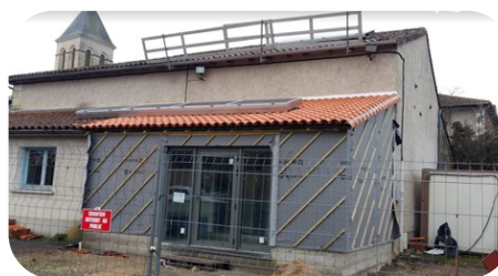
Panneaux photovoltaïques installés
