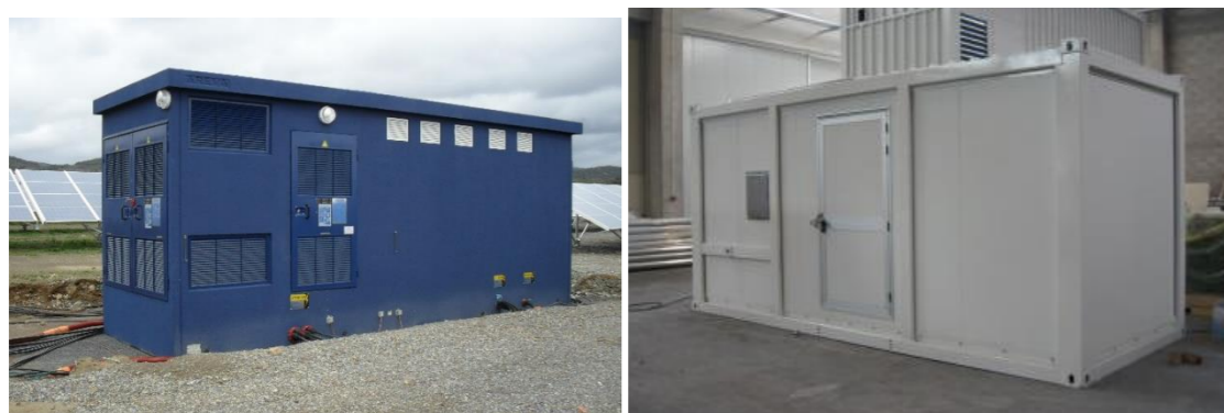
Illustration 13 : Exemples d'onduleurs et transformateur installés dans des postes béton et containers
