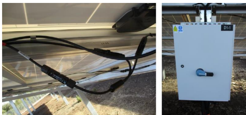
Illustration 12 : Exemple de câble électrique et de boîte de raccordement – RES
