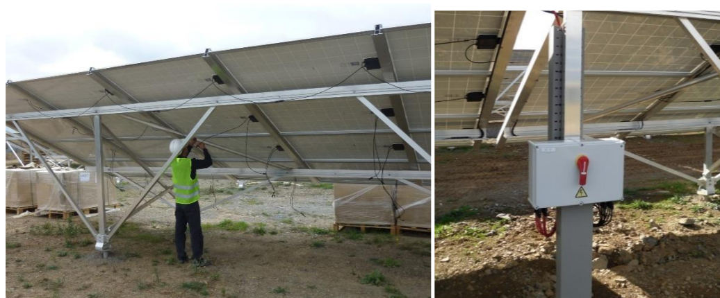
A gauche : Câblage des panneaux – A droite : Boîtier de raccordement - RES
