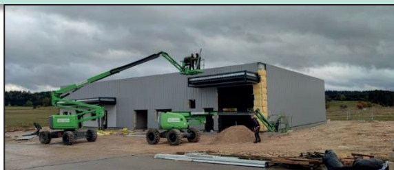
Construction sur la zone d'activités économiques des Butiques 2 au Russey des futurs locaux de la SARL « Fernand HUGONIOT ».
