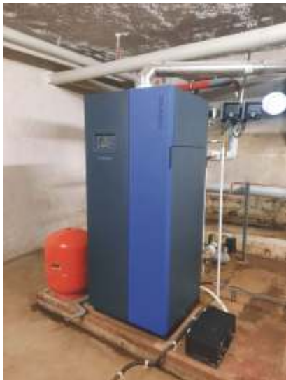
Chaudière de l'Eglise
