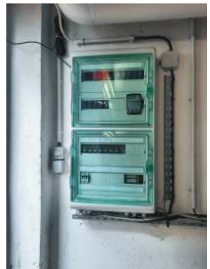
Compteur communicant de la mairie
