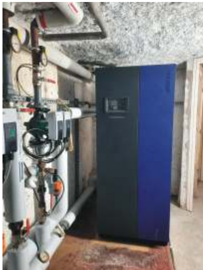
Chaudière de la salle Riom
