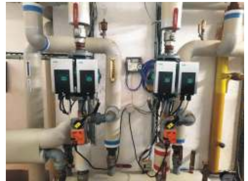
Pompes de la salle Riom
