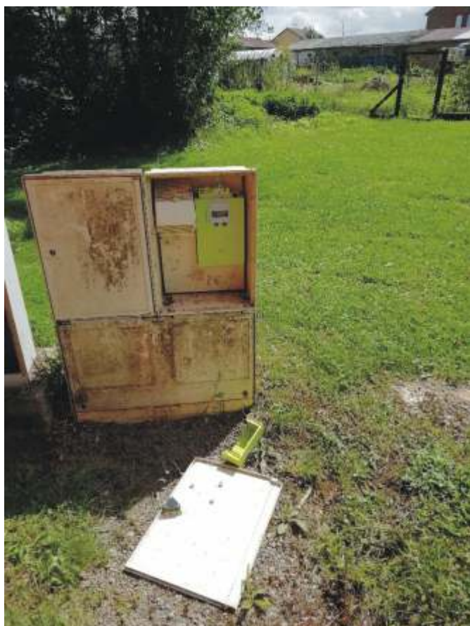
Détérioration du coffret électrique et jets de chaises dans le bassin de la station d'épuration à la Cité Ida
