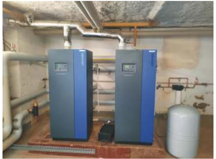
Chaudière école Victor Hugo
