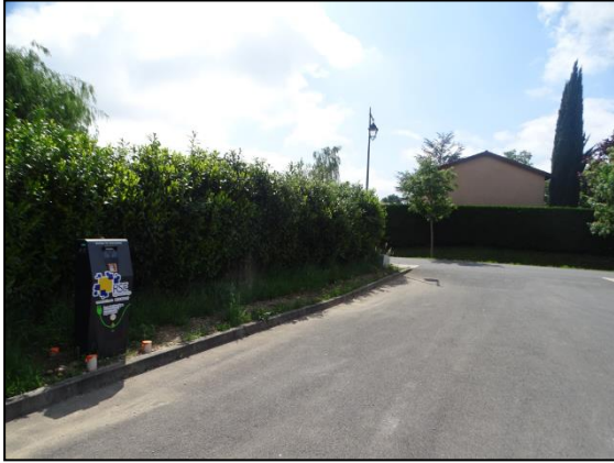
Borne de recharge pour véhicule électrique aux terrains de loisirs
