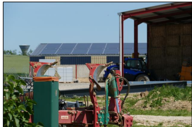
Panneaux photovoltaïques équipant les bâtiments de l'exploitation agricole implanté aux Teinturières
