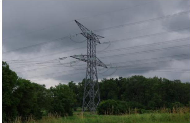
Ligne THT à Chaudenou
