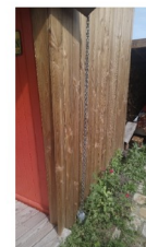
Chaîne de pluie remplaçant une gouttière (source : Agglopolys).
