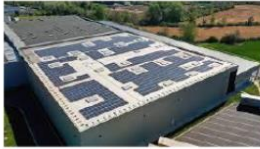
Photovoltaïque en toiture
