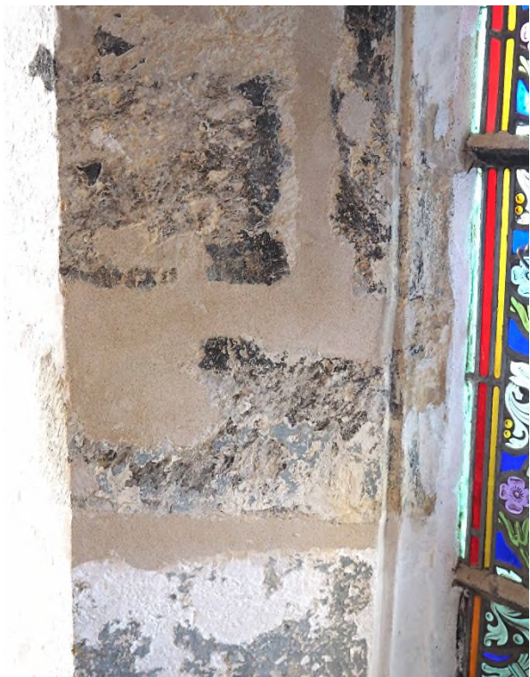
Fig.23. Ébrasement dextre après colmatage.
