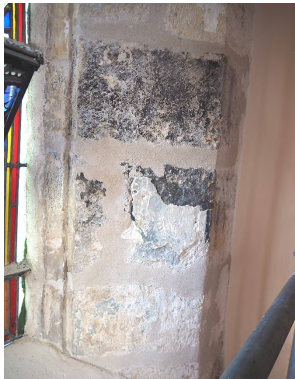
Fig.24. Ébrasement senestre après colmatage.
