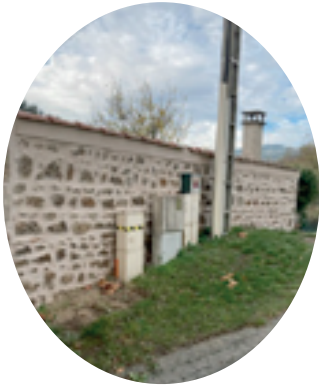
Reprise du mur du local des chasseurs au Vieil Ecotay Stone-rénovation d'Ecotay Total = 1 300€
