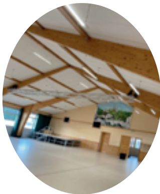
Rénovation de l'électricité par des LED de la salle des fêtes Société Peillard Total = 5 238 €
