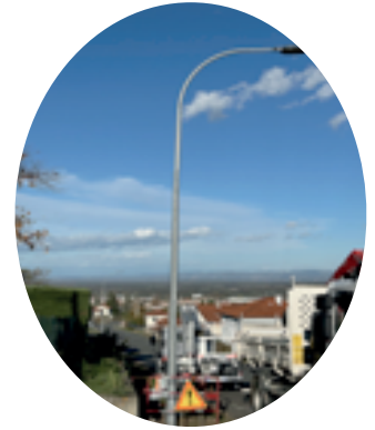
Changement du mât suite aux dégâts du vent route de Montbrison
