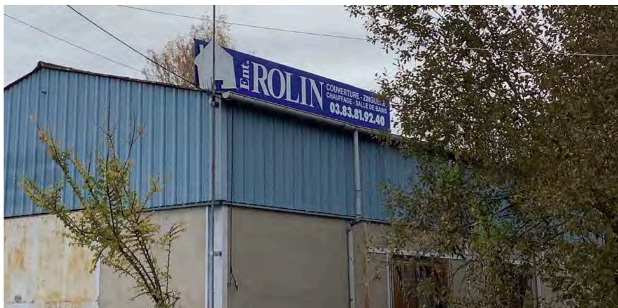
Enseigne sur toiture non réalisée en lettres découpées, Pont-à-Mousson, novembre 2022.
