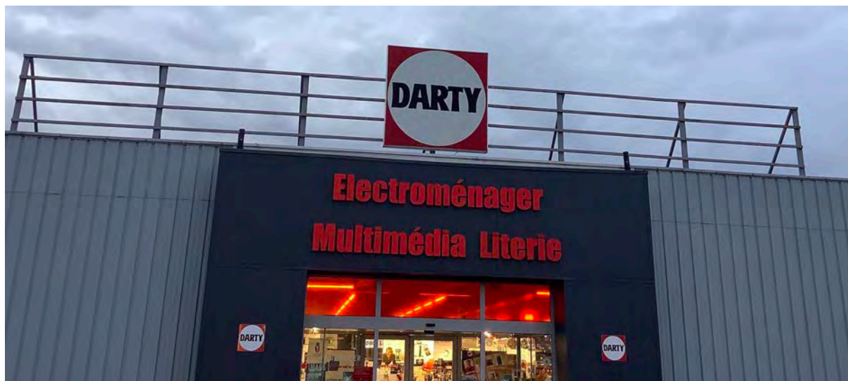
Enseigne sur toiture non réalisée en lettres découpées, Pont-à-Mousson, novembre 2022.
