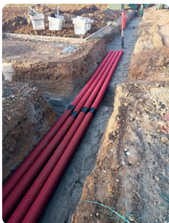
Tubes d'alimentation électrique
