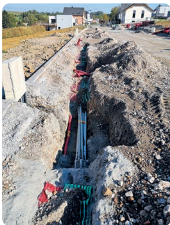
Télécoms, gaz et électricité avec filets avertisseurs de couleur
