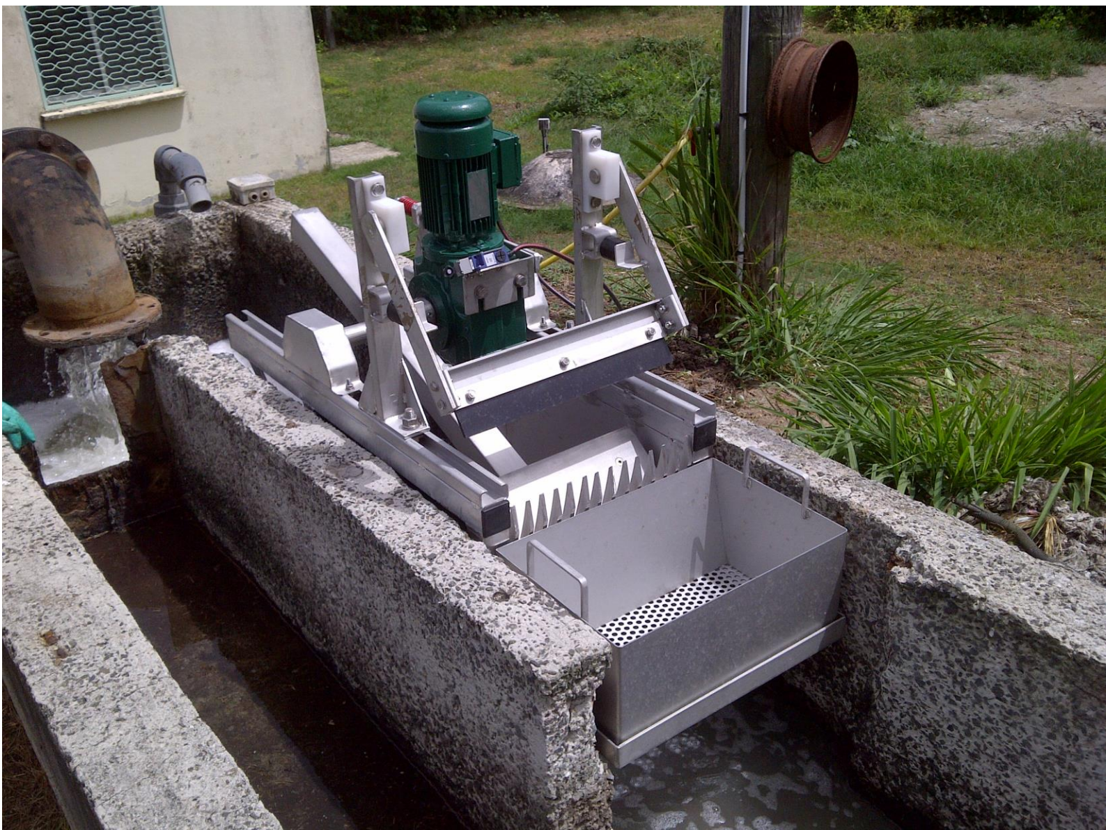
Dégrilleur STEP Folle Anse
