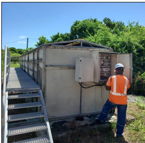
Suivi de la maintenance électrique sur l'application KIZEO à la station biodisque de Domblière – Phase test
