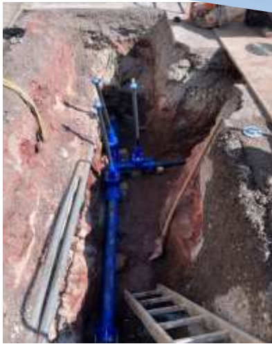
Vannes de sectionnement
