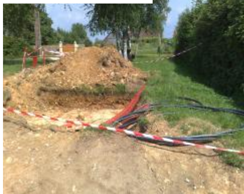
Emplacement des futurs transformateurs
