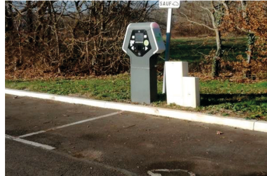
Borne de recharge pour voitures électriques
