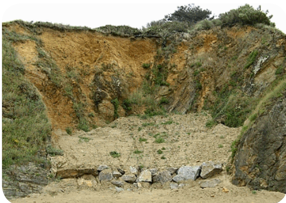
Exemple d'éboulement-chute de blocs : La Bernerie-en-Retz
