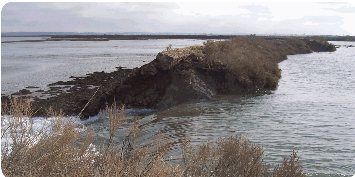
Batz-sur-Mer, brèche occasionnée par la tempête Xynthia : 27 et 28 février 2010
