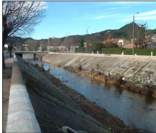
De nombreux parapets ont été emportés pendant la crue (parties plus claires refaites à neuf)
