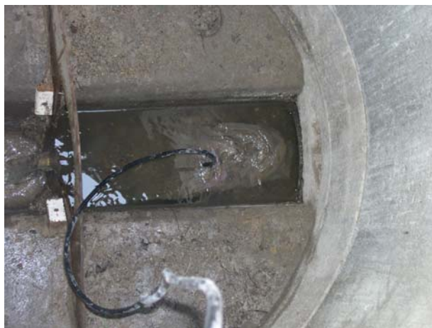
Figure 31 - Exemple d'encrassement d'un seuil
