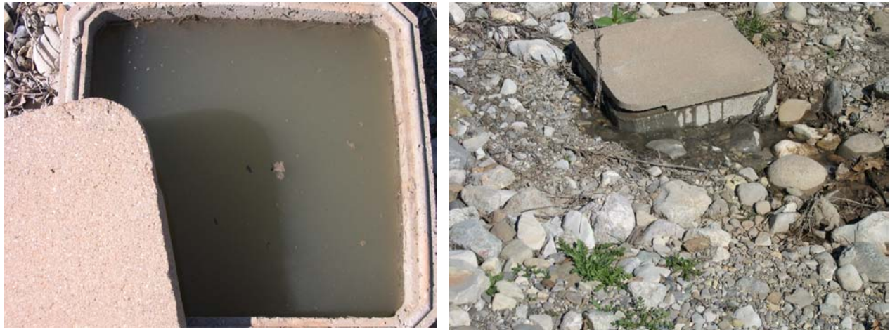
Figure 32 - Photographies des regards de répartition en amont des drains
