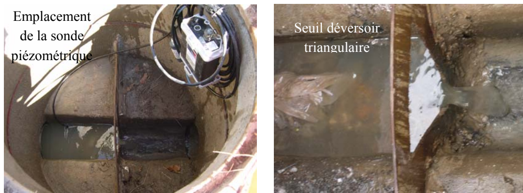
Figure 24 - Photographies d'un dispositif de mesure de débit
