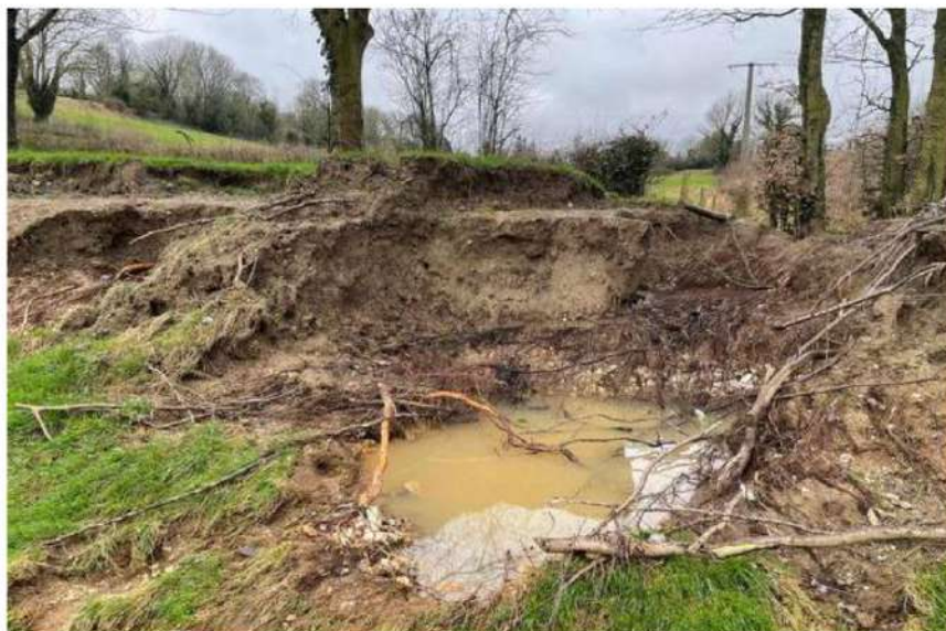
Au stade de foot de Zudausques, les dommages sont importants.
