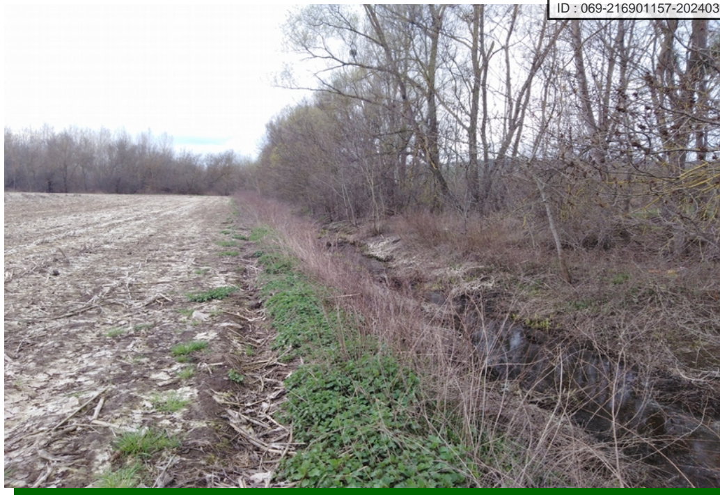
Ces deux photos ci-dessus illustrent en partie l'état dégradé du ruisseau du Bourdelan , 18 mars 2021
