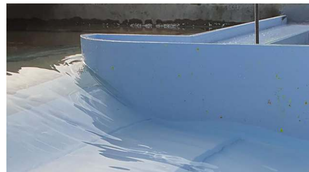
Photographie 2 : Vue sur le profil incurvé du bajoyer rive gauche de barrage
