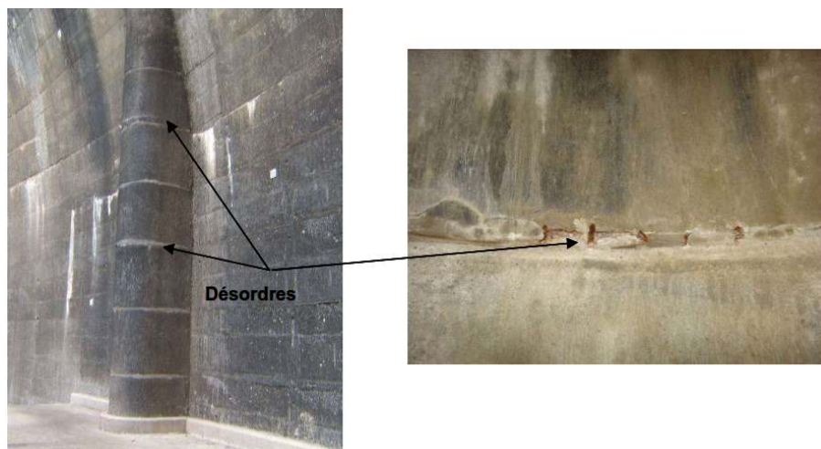
Photographie 10 : Désordres observés sur la cheminée aval avec des vues de l'extérieur et de l'intérieur
