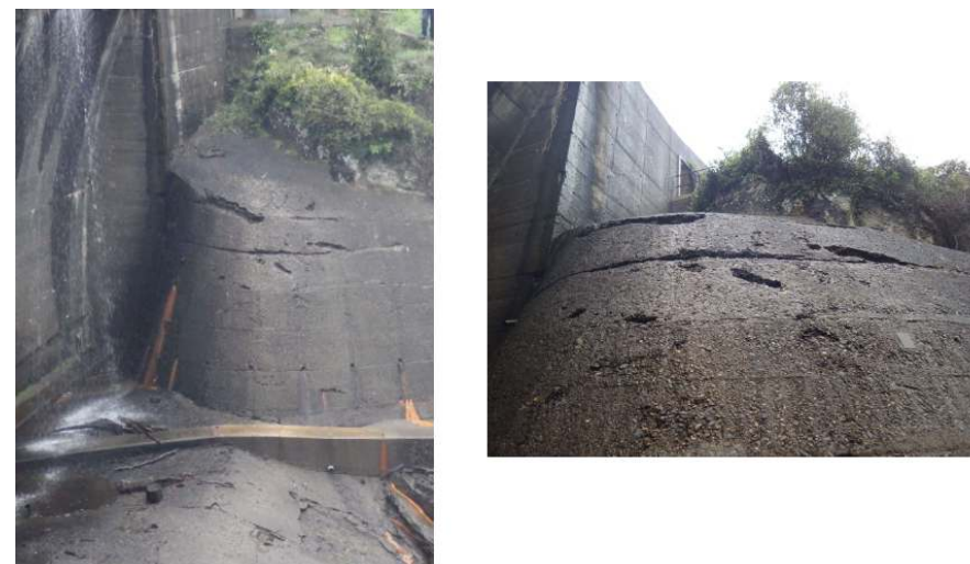
Photographie 11 : Désordres sur le massif, rive gauche du barrage
