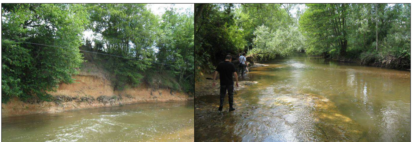
Figure 4-3 illustration du caractère dynamique de l'érosion subie par la rive gauche en partie amont du tronçon (talus subvertical / image de gauche), puis de l'incision du lit au sein même du substratum (image de droite montrant le maintien d'une large plaque d'argile ou marne dure en pied du versant affouillé) – Clichés Biotec, juin 2009.
