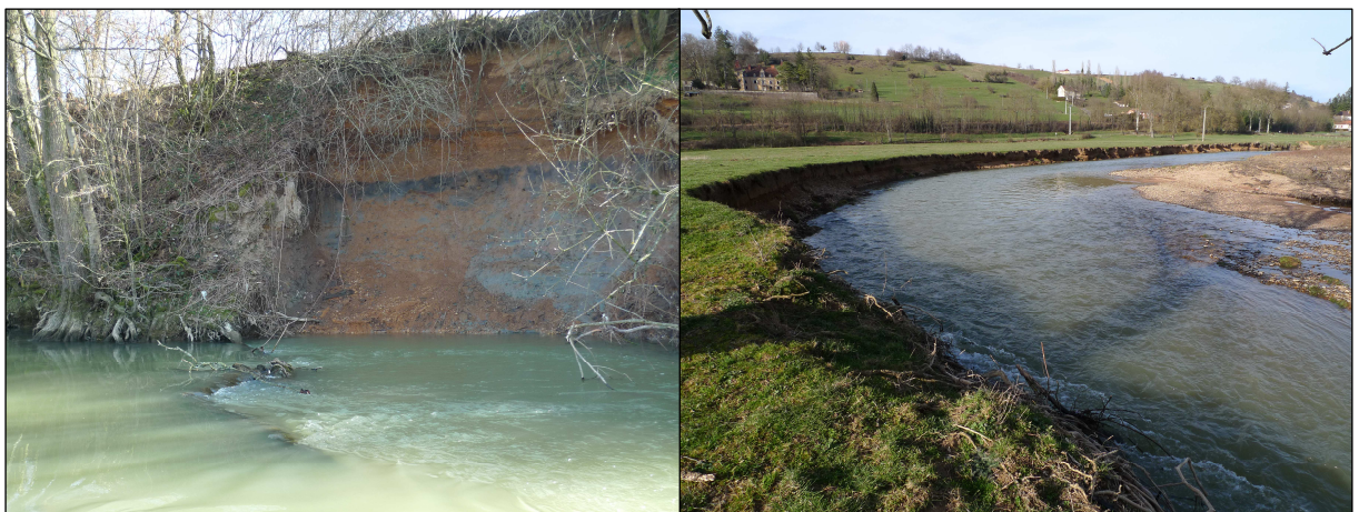
Figure 5-4 Illustration du travail érosif de la rivière sur un versant (glissement de la couche peu épaisse des sols et mise à nu de la « roche mère » (substratum) sous l'effet conjoint du poids des arbres en surplomb), puis en concavité de méandre (cas d'une érosion particulièrement dynamique) - Clichés Biotec, août 2009 & mars 2010.
