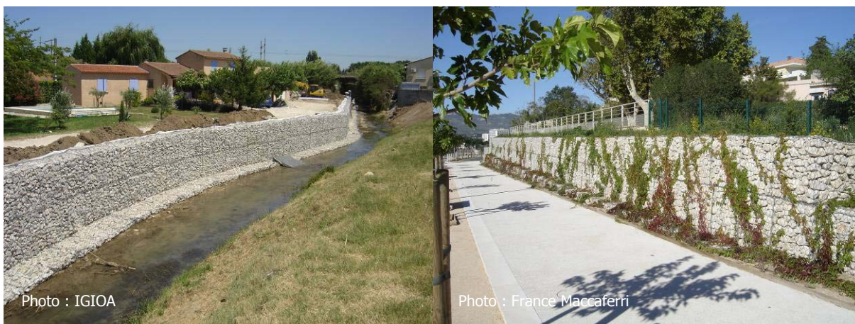
Photo 11 : Exemple de réalisations en gabions ; à droite, possibilité de végétalisation par des plantes rampantes
