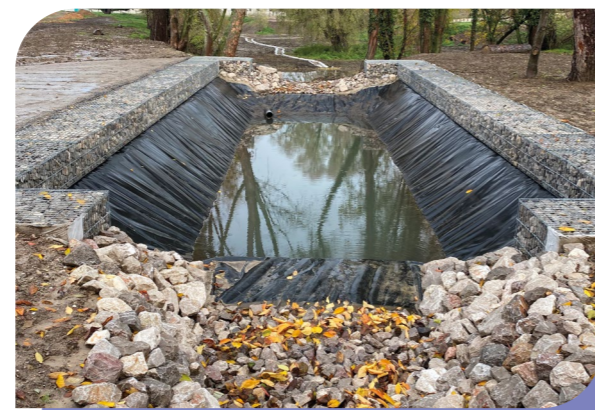
Bassin de décantation - ouvrage hydraulique participant au traitement de l'eau pluviale.
