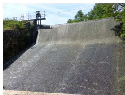
Prélèvements d'eau et Activité hydroélectrique, barrage
