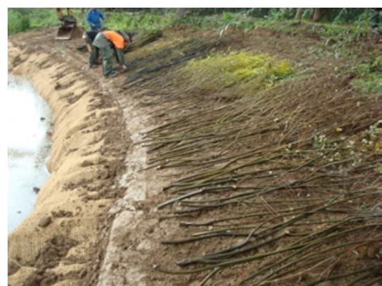
Figure 17 : Pose de lit de plans et plançons et fascinage sur l'amont du caisson
