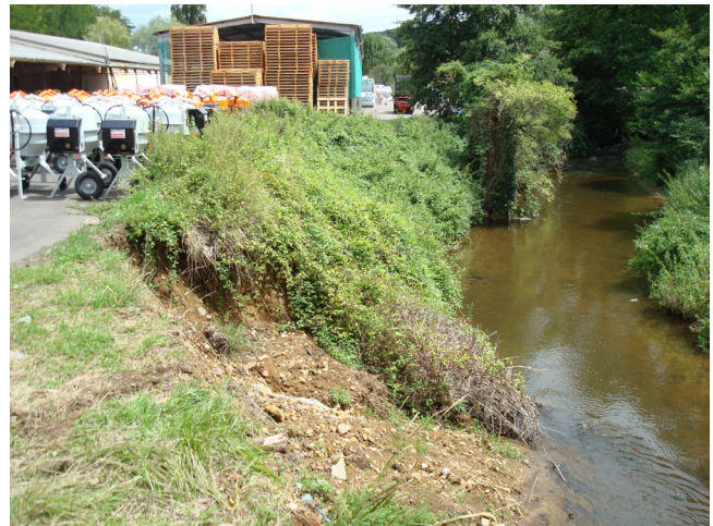
Figure 35 : Érosions au droit de l'entreprise ALTRAD sur le Sornin
