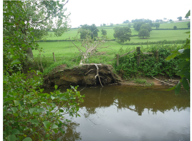
Figure 47 : Chute de Peuplier sur le Sornin aval
