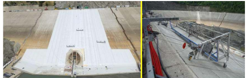
Photographie 6 : Nacelles suspendues mobilisées dans le cadre des travaux sur La Coche en 2018
