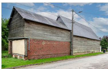
Bâtiments agricoles essentés en clins de bois, n°5 rue de Doméliers, vue depuis le nord-est. Phot. Marc Kérignard IVR32_20216000849NUCA
