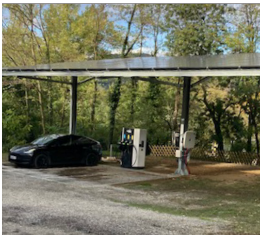
BORNE DE RECHARGE ÉLECTRIQUE 7 rue Louis Aragon 07800 LA VOULTE SUR RHONE
