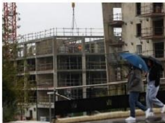
En cours de construction, le parking silo thionvillois de la gare est perfusé de fonds luxembourgeois. Photo d'archives Philippe Neu
