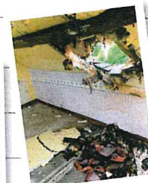
Dégâts sur le 43 Lancy
