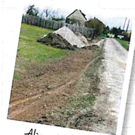
Alimentation en eau du cimetière
