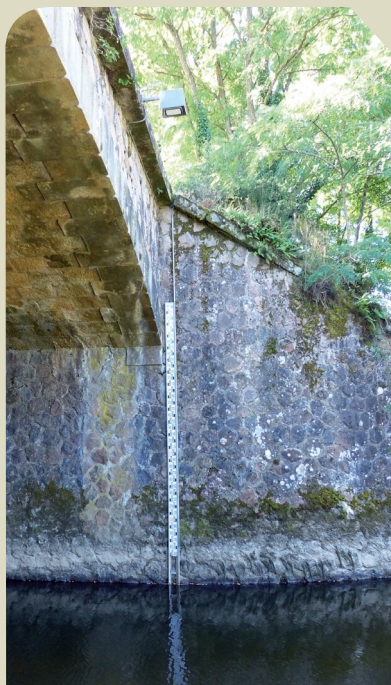
Échelle limnimétrique et capteur radar sur le Sornin à La Chapelle/Dun, pour mesurer en continu le niveau d'eau et sa température
