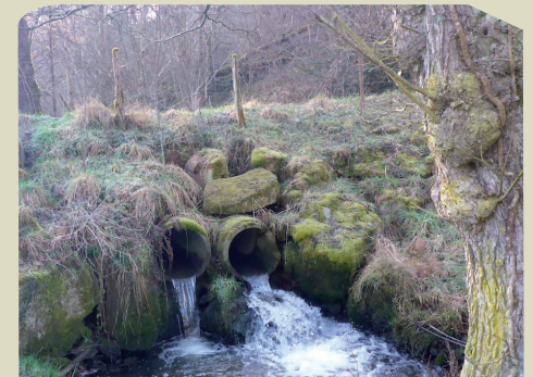
Buses à remplacer par un pont cadre sur le ruisseau du Tesche
