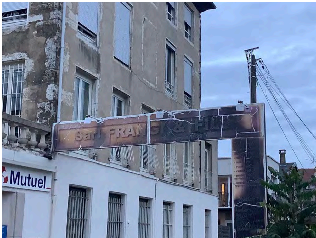
Enseigne en mauvais état d'entretien, Pont-à-Mousson, novembre 2022.
