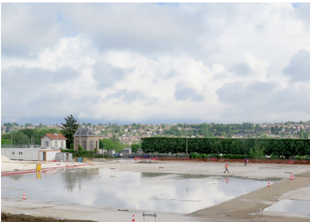
Toujours à Lagny, les travaux de la nouvelle caserne de pompiers ont commencé à côté du COSEC et du collège Marcel Rivière, sous maîtrise d'ouvrage du SDIS.
