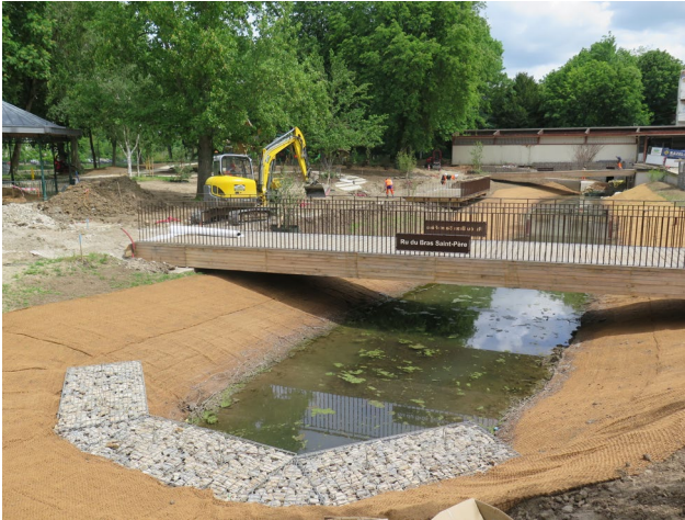
Les travaux des bords de Marne se terminent à Lagny avec la réhabilitation du square Foucher de Careil où le ru du Bras Saint Père coulera à nouveau à ciel ouvert. L'opération est menée par Marne et Gondoire.
