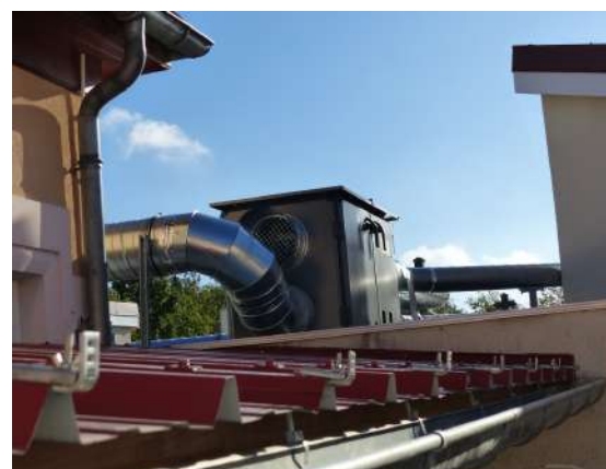
Centrale de Traitement de l'Air (CTA) double flux pour un air plus sain dans les locaux, avec récupération des calories.
