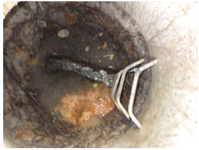
Infiltration, Racines –Regard n° 29669 – Réseau EU– Chez Guardia
