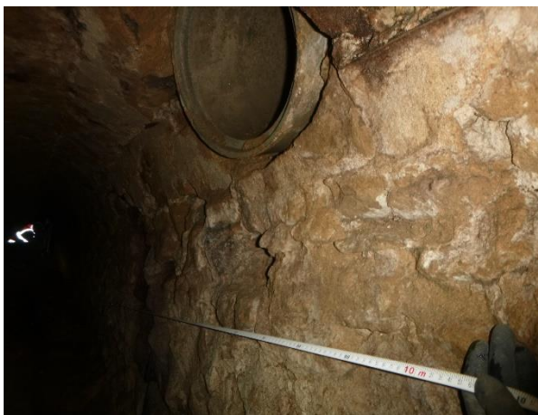
Conduite n°5 - 400 Béton
