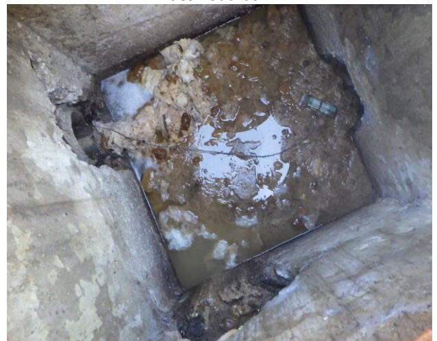
Dépôts, Stagnation d'effluents – Regard n° 21034 – Réseau EU – Rue des 4 Vents
