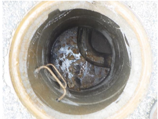
Dépôts– Regard n° 5938 – Réseau EU – Quartier Bellevue
