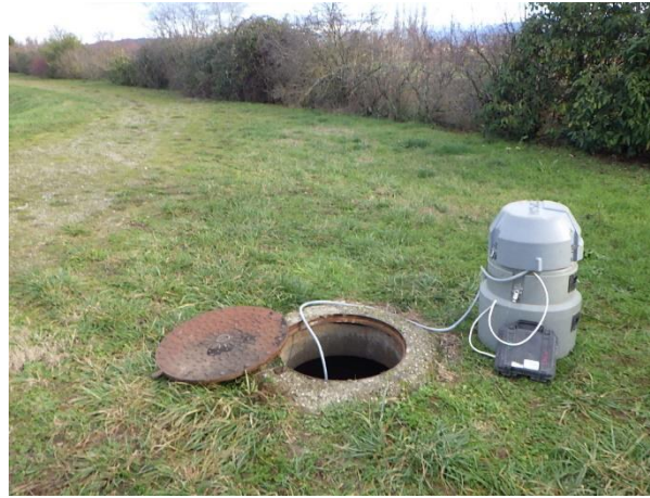
Vue extérieure entrée de STEP
