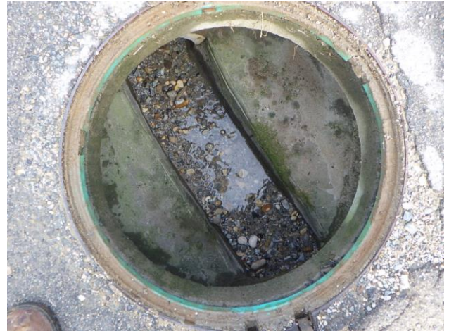
Dépôts –Regard n° 29685 – Réseau unitaire – Chemin des Boudras
