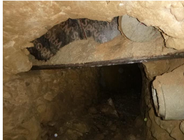
Conduite n°3 - 100 Béton
