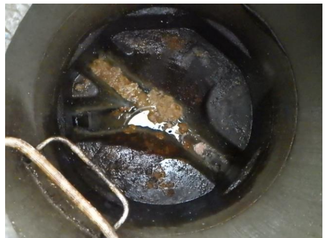
Dépôts – Regard n°199 –Réseau EU – Lotissement Le Bartalene
