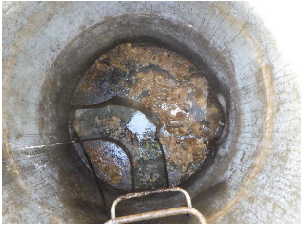
Stagnation d'effluents - Dépôts –Regard n° 29676 – Réseau EU – Rue du Tacot
