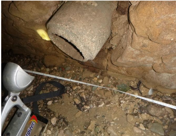
Conduite n°4 - 100 Béton
