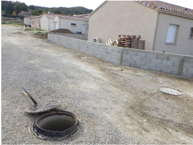
Cadre non scellé – Regard n°21 – Réseau EU- Rue du Pécher
