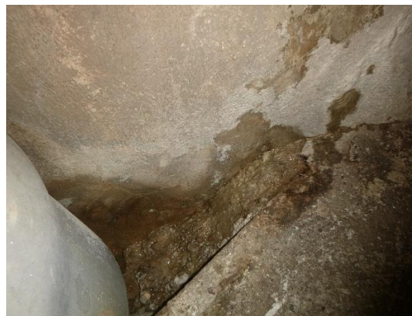
Suintement en partie EP (près de la chute accompagnée)
