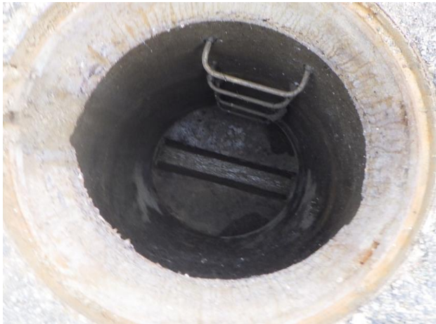
Traces de mise en charge – Regard n° 1341 –Réseau EU – Quartier Bellevue
