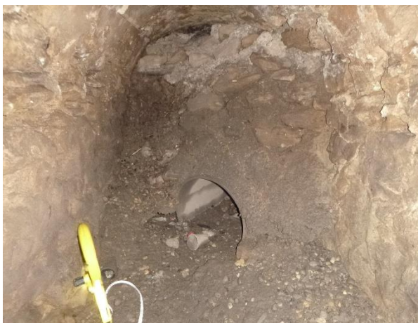
Conduite n°6 - 400 PVC en sortie
