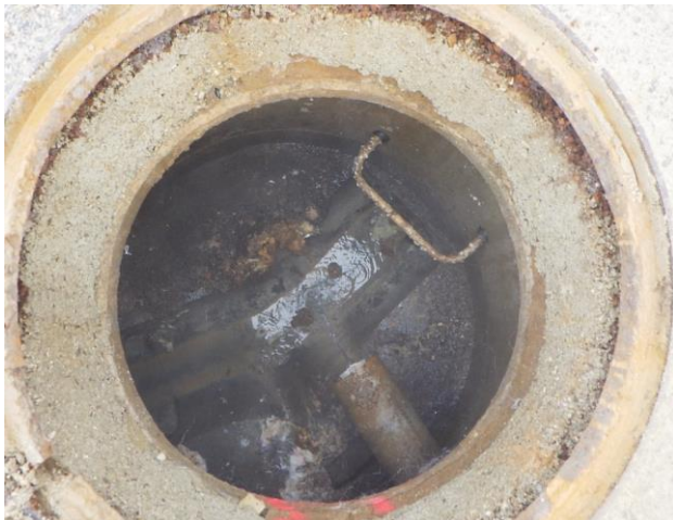
Dépôts– Regard n° 21043 – Réseau unitaire – Le Village
