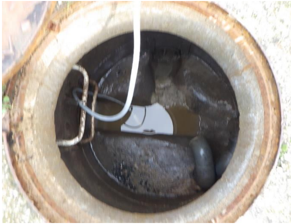
Vue intérieure entrée de STEP
