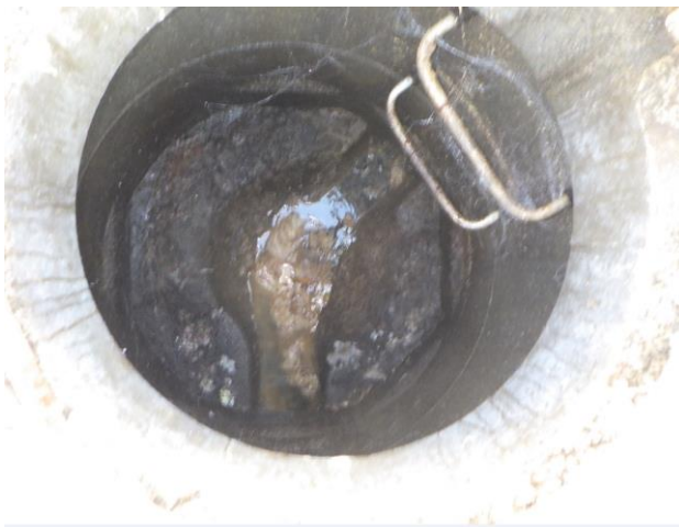
Dépôts – Regard n° 101866 – Réseau EU – Rue des Ecoles
