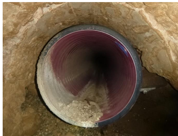
Conduite n°1 - 500 PEHD
