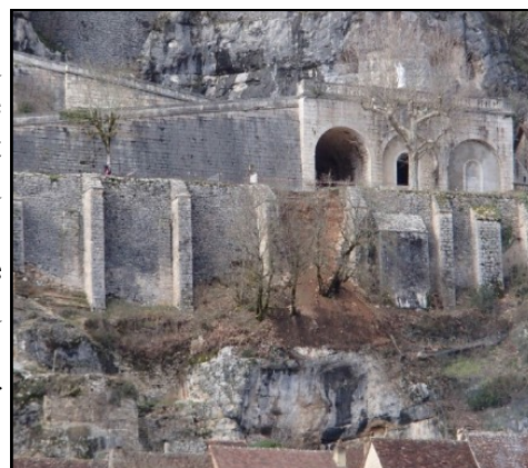
Mur de l'esplanade Michelet suite à l'effondrement partiel – 16-02-2016
