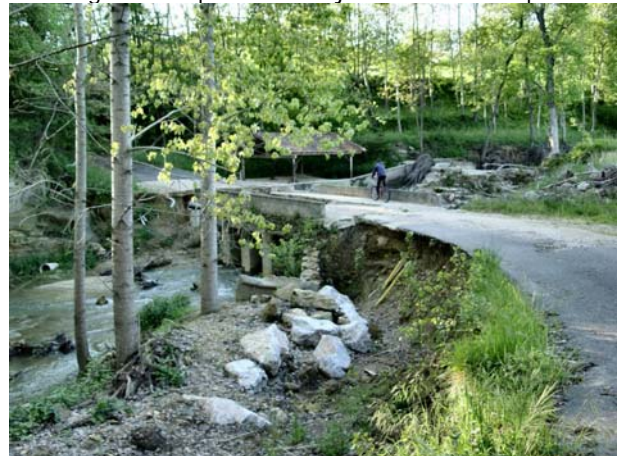
Pont sur l'Aybes route d'En Auriol après l'orage du 4 juin 2003
