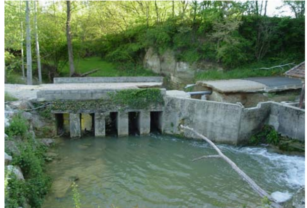
Pont sur l'Aybes la chaussée a été emportée lors de la crue à la suite de l'orage du 4 juin 2003
