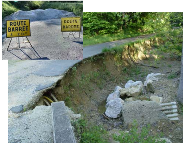
la chaussée a été emportée lors de la crue du 4 juin 2003
