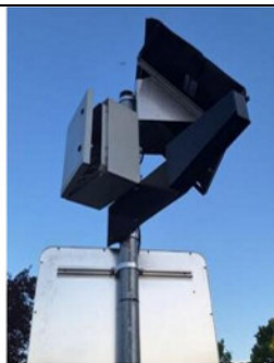
Le boîtier recevant les batteries a été fracturé.
