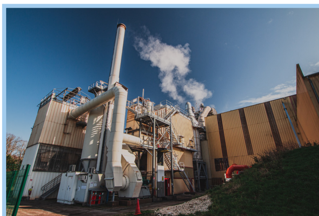
Une Unité de Valorisation Énergétique (UVE)
