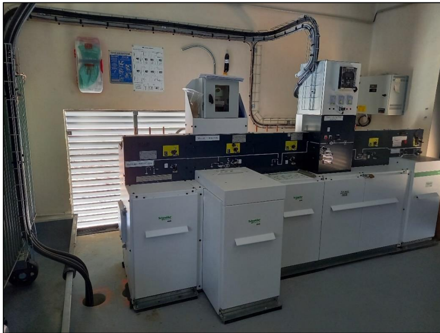
Figure 36 - Cellules de la centrale de Toirac
