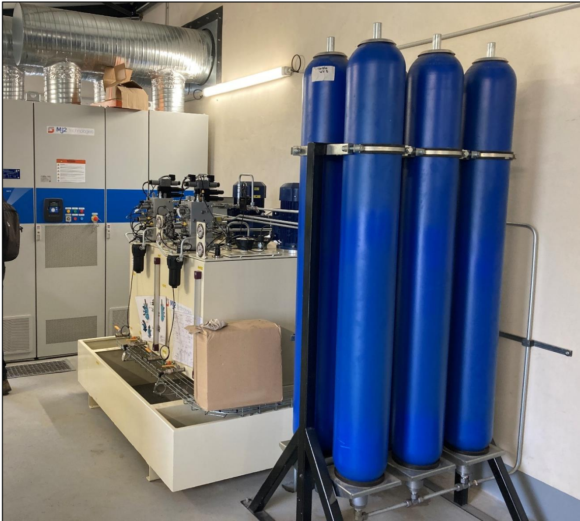
Figure 38 - Groupe oléo-hydraulique et ses accumulateurs
