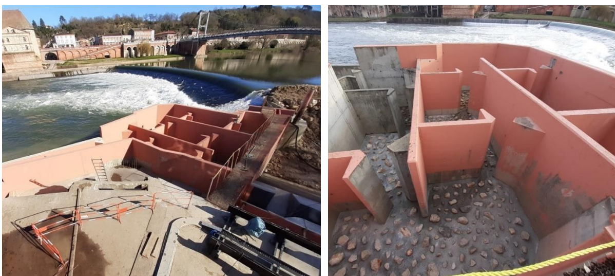
Figure 28 – Passe à poissons de Villemur-sur-Tarn
