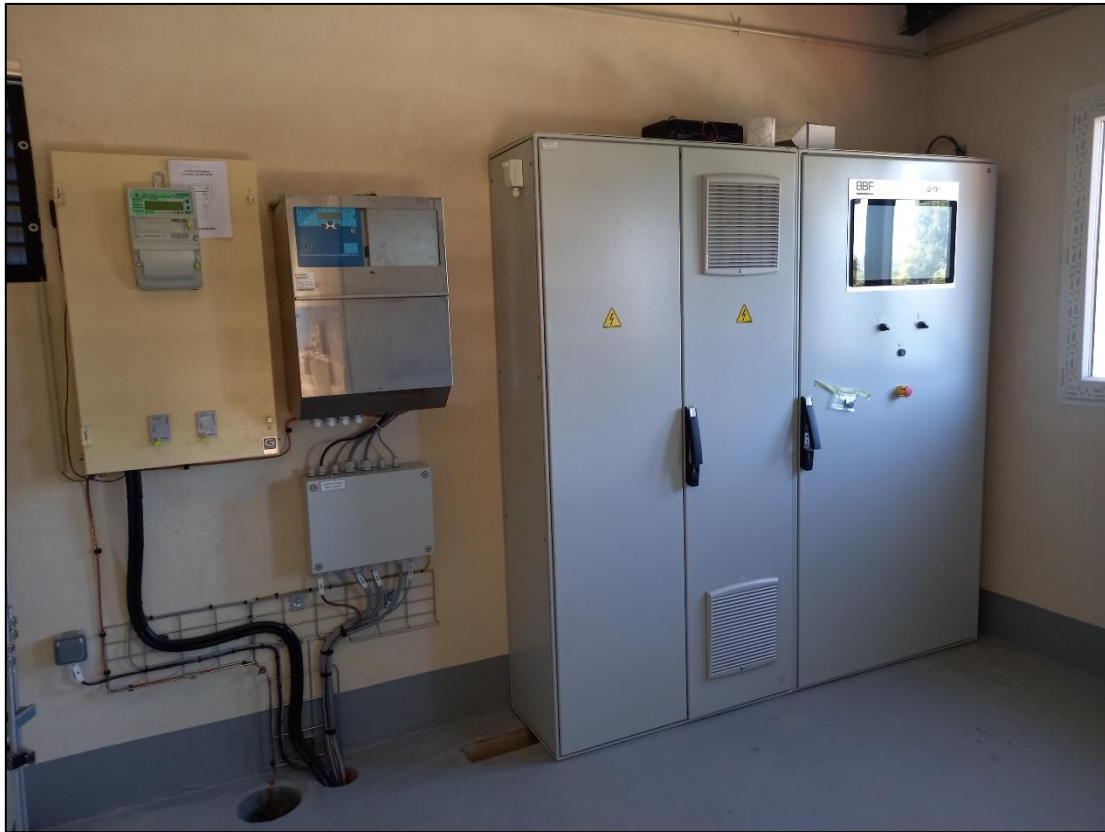
Figure 37 - Exemple d'armoire de contrôle/commande (ici, à droite, celle de la centrale de Toirac)
