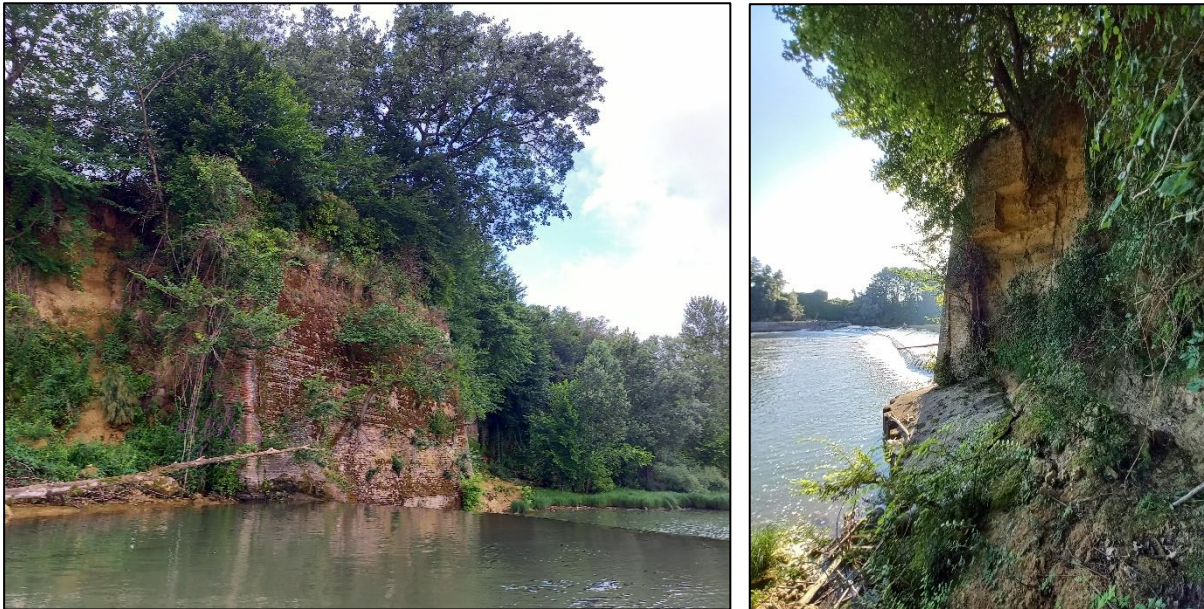
Figure 5 – Vue du voile rive gauche
