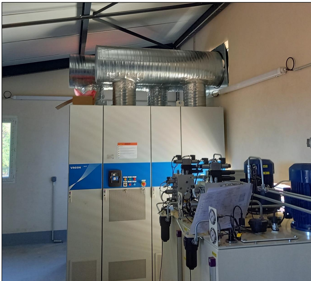
Figure 34 - Convertisseurs de fréquence de l'usine de Toirac
