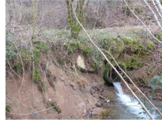
Figure 39 : Exemples de buse en mauvais état sur l'amont du Jarnossin de Sévelinges
