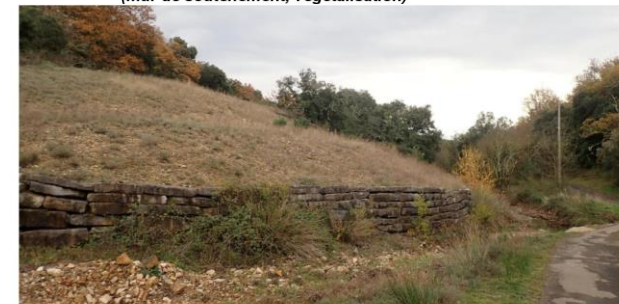
Figure 88 : Vue sur le talus stabilisé des haldes de laverie, et sur le mur de soutènement situé à la base.
