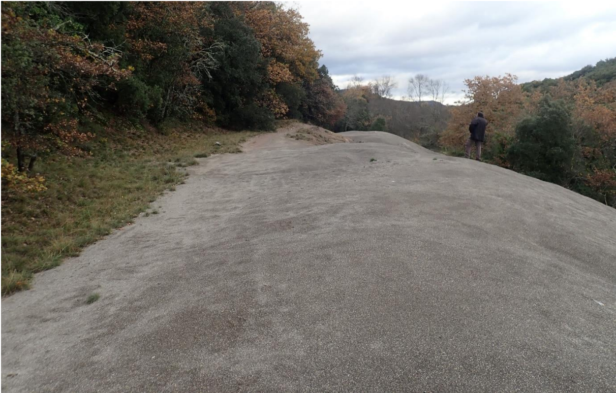
Figure 86 : Vue sur le haut de la digue à stériles. Un canal de conduite des eaux de pluie peut être aménagé sur le sommet de la digue pour éviter le ravinement de la digue
