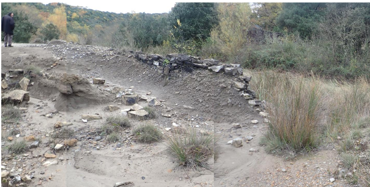
Figure 83 : Vue sur l'intérieur du bassin de décantation dont une partie du mur de retenue s'est effondrée.
