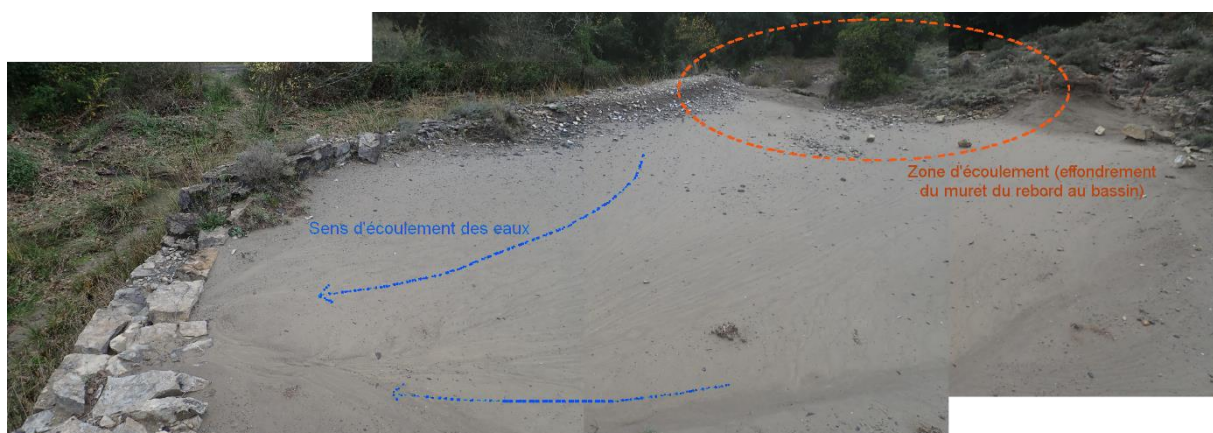
Figure 82 : Bassin de décantation et son contenu en résidus de traitement fins et limoneux largement raviné par les eaux de ruissèlement
