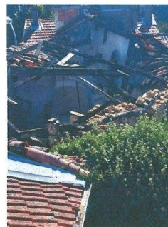
Mitoyenneté avec un voisin (fuites dans sa maison)
