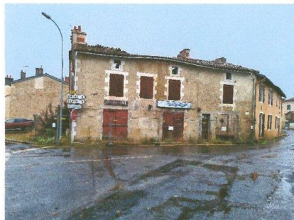
Danger pour les passants
