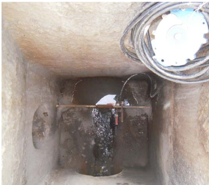
Figure 4 : Matériel mis en place
