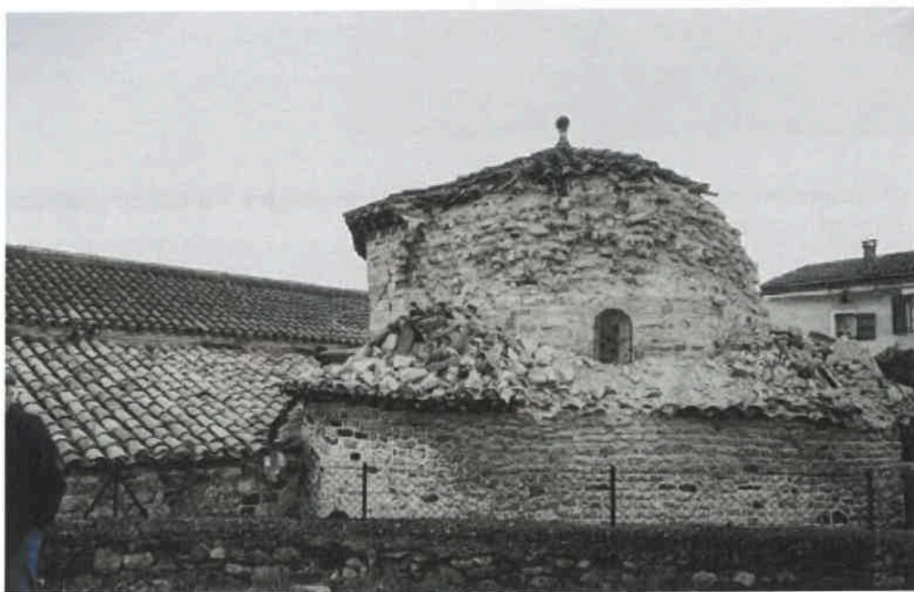
Dégâts du séisme du 11 Novembre 2019 (Magnitude 4,8-4,9 et Intensité locale VII-VIII) au Teil (Ardèche) sur le toit d'un baptistère.
